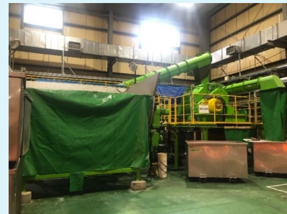
A : 前処理棟 (分別機)
